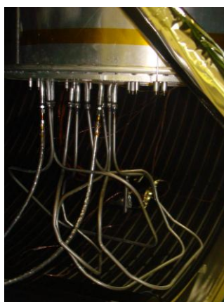
Figura 3.4 - Detalhe dos tubos de aço inox que conectam os estágios do MNP.
